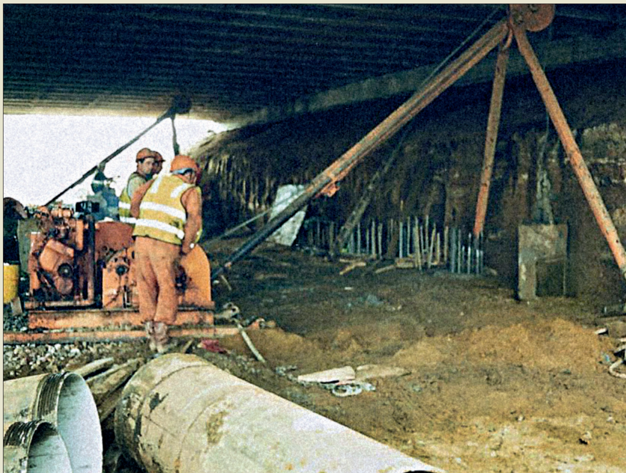
Obr. IV. 38: Provádění pilot firmou Stent Foundation ve stísněných podmínkách s vrtáním pomocí nízké trojnožky – přestavba dálničního mostu ve Velké Británii roku 1991
