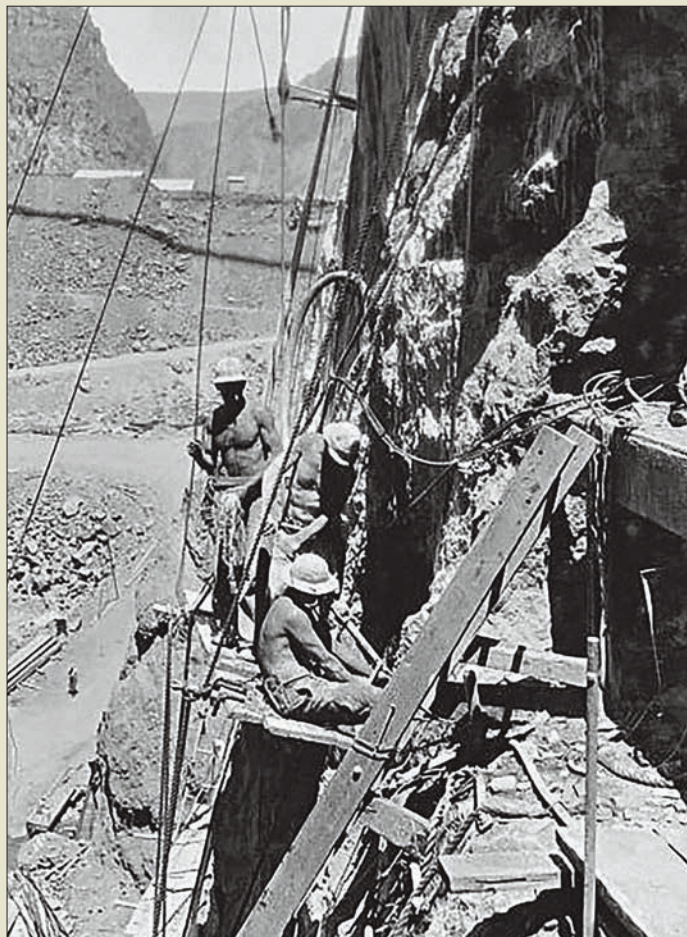
Obr. VI. 11: Injektáž bočního skalního svahu pro Hooverovu přehradu na řece Colorado v USA roku 1933. Cementová směs se injektovala do vrtů hlubokých 17 m.
