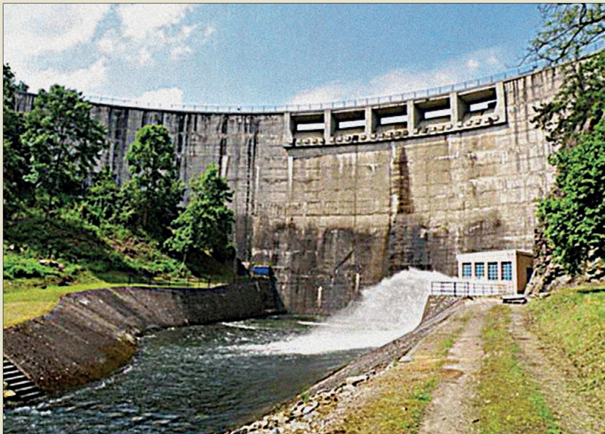
Obr. VI. 27: Klenbová hráz Vrchlice u Kutné Hory, vysoká 40,8 m, s provedenou kontaktní injektáží mezi železobetonovými bloky tělesa
