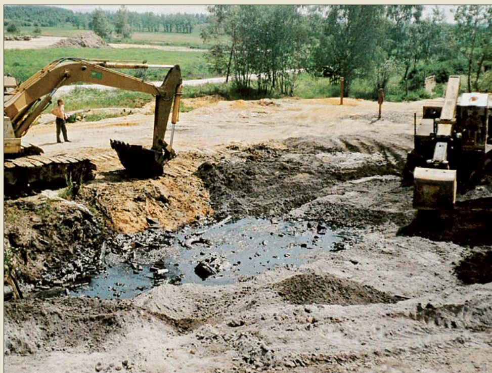
Obr. VI. 130: Odtěžování ložiska dehtových odpadů a postupná stabilizace zbytků speciální solidifikační směsí in-situ firmou Soletanche ČR při sanaci skládky Kema Skalná roku 1997
