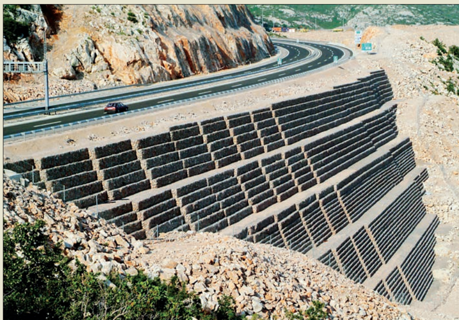
Obr. VI. 96: Konstrukce násypu chorvatské dálnice A1 Záhřeb–Split u tunelu Sveti Rok ze zeminy vyztužené systémem Terramesh s gabiony o celkové výšce 30 m v roce 2001 (maccaferri.sk)
