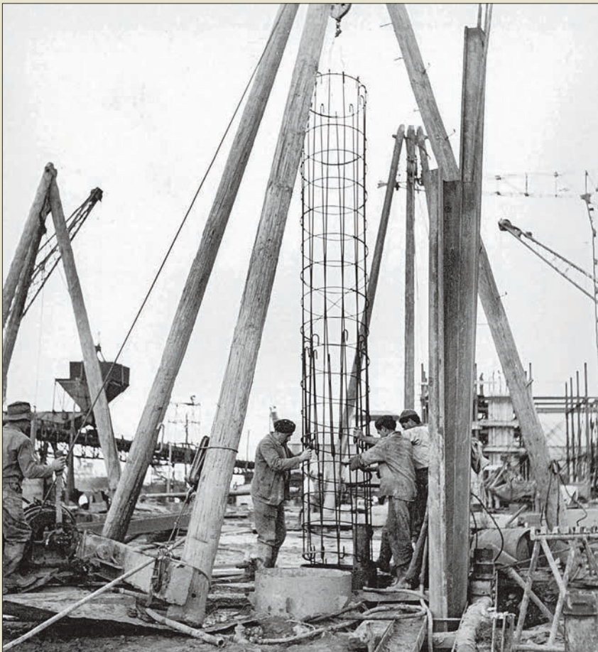
Obr. IV. 37: Stavba s vrtáním pilot několika soupravami trojnožek klasickým nárazovým způsobem pomocí elektrického lanového vrátku, jímž byly také osazovány armokoše staveniště Bone Centrale firmy Soletanche, Francie, 1950.
