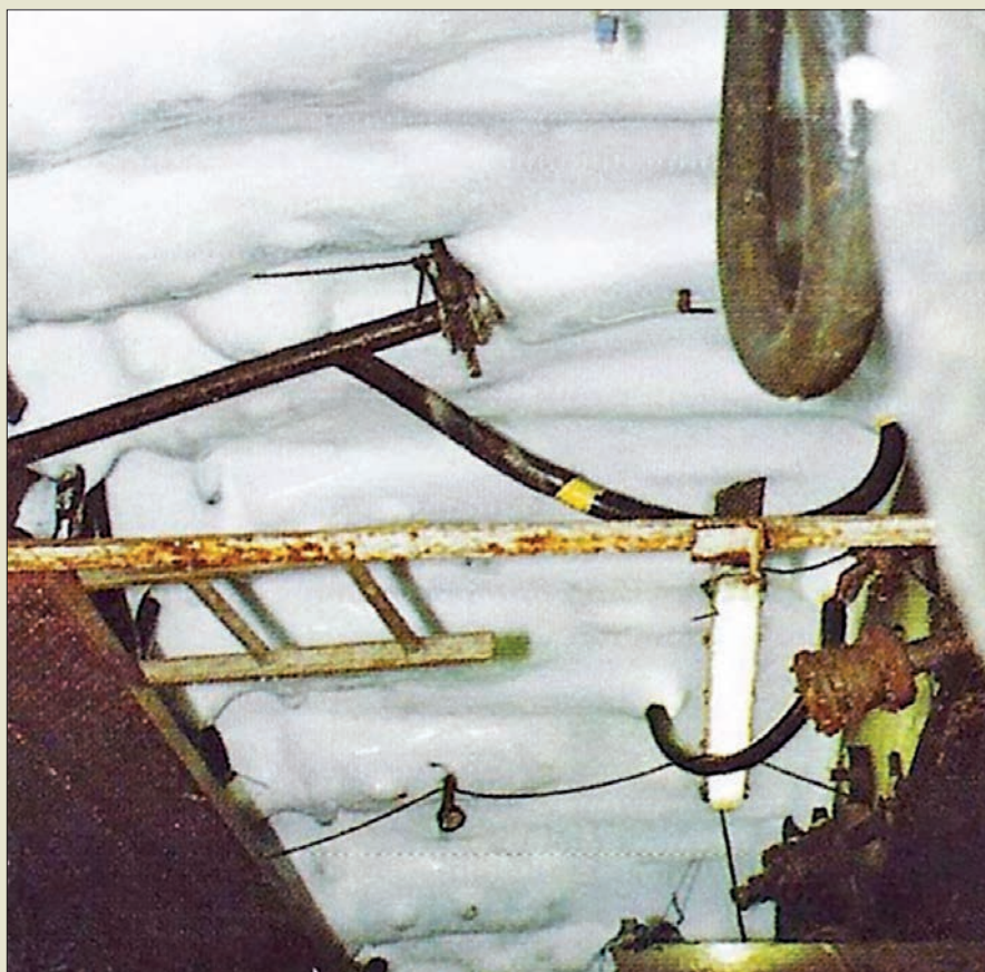
Obr. VI. 124: Zmrazené okolí břitu štítu soupravy TBM pod vějíří zmrazovacích vrtů se solankou pro výměnu řezných hlav stroje na stavbě podmořského tunelu Storebaelt roku 1994, firma Soletanche
