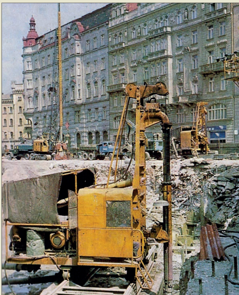
Obr. V. 50: Nárazové soupravy Rodio RF-6 s reverzní cirkulací na stavbě pražského obchodního domu Kotva v roce 1972, v pozadí jedna z tehdy nově zavedených souprav Rodio s vedeným Kellydrapákem na bagrjeřábu UB 160 z NDR (Zakládání staveb, a. s.)
