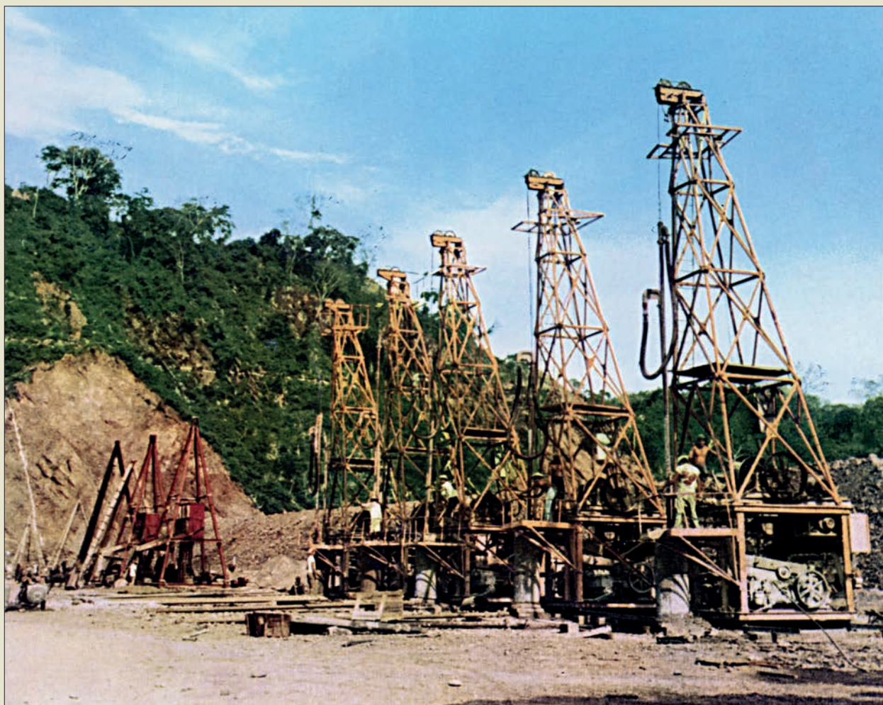
Obr. V. 46: Soupravy firmy I.C.O.S. na stavbě podzemní clony o maximální hloubce 89 m pro mexickou přehradu Villita roku 1965; v popředí původní technologie nárazově vrtaných „milánských stěn“ pro hluboké úseky, v pozadí trojnožkové soupravy s lehkými drapáky pro mělké úseky
