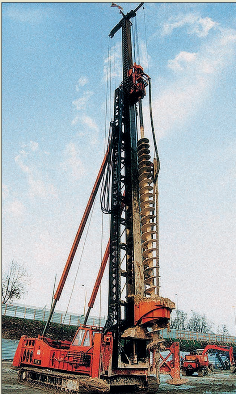
Obr. IV. 56: Souprava firmy Soletanche pro vrtání pilot CFA typu Starsol s teleskopickým vnitřním soutyčím, spodní vrtnou korunkou a odstraňovačem odvrtné ve Francii roku 1978
