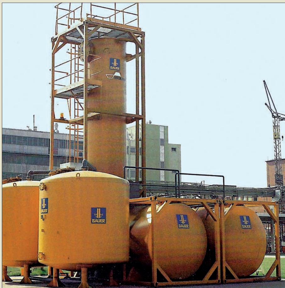
Obr. VI. 131: Dekontaminační stanice firmy Bauer pro odstraňování chlorovaných uhlovodíků stripováním a filtrací při klasické metodě pump-and-treat roku 1987 na pozemku farmaceutické továrny v Bádensku- -Württembersku
