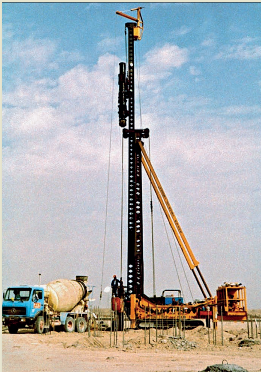
Obr. III. 13: Pilotovací souprava Vibrex na stavbě elektrárny Al-Anbar v Iráku roku 1989 (Zakládání staveb, a. s.)
