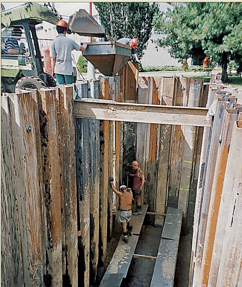
Obr. VI. 136: Reaktivní brána pro sanaci znečištění v podniku Autopal Hluk roku 2001 (Zakládání staveb, a. s.)
