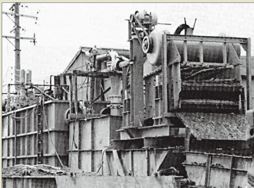
Obr. V. 58: Technologický oddíl výroby a čištění suspenze při těžbě podzemních stěn s reverzní cirkulací v roce 1974 u japonské firmy Tone Boring: vpravo mohutné tandemové konvenční vibrosíto, za ním střední hydrocyklon
