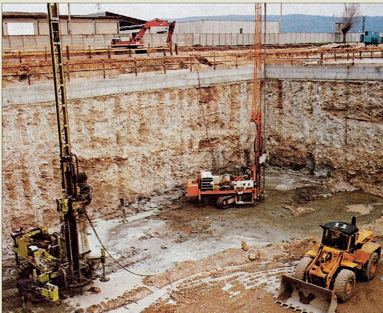
Obr. VI. 49: Pažení stavební jámy firmou Fondazioni Speciali v ideálních podmínkách štěrkové základové půdy pomocí sloupů tryskové injektáže o průměru 1,2 m v Itálii roku 1982
