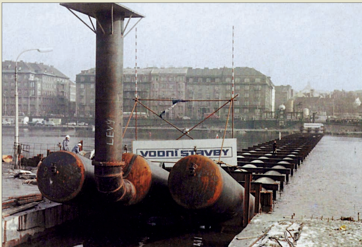
Obr. V. 10: Trojramenná shybka pro kmenovou stoku K v Praze z ocelových rour o průměru 1500 mm a délce 220 m před ponořením na dno Vltavy v roce 1975 (Zakládání staveb, a. s.)
