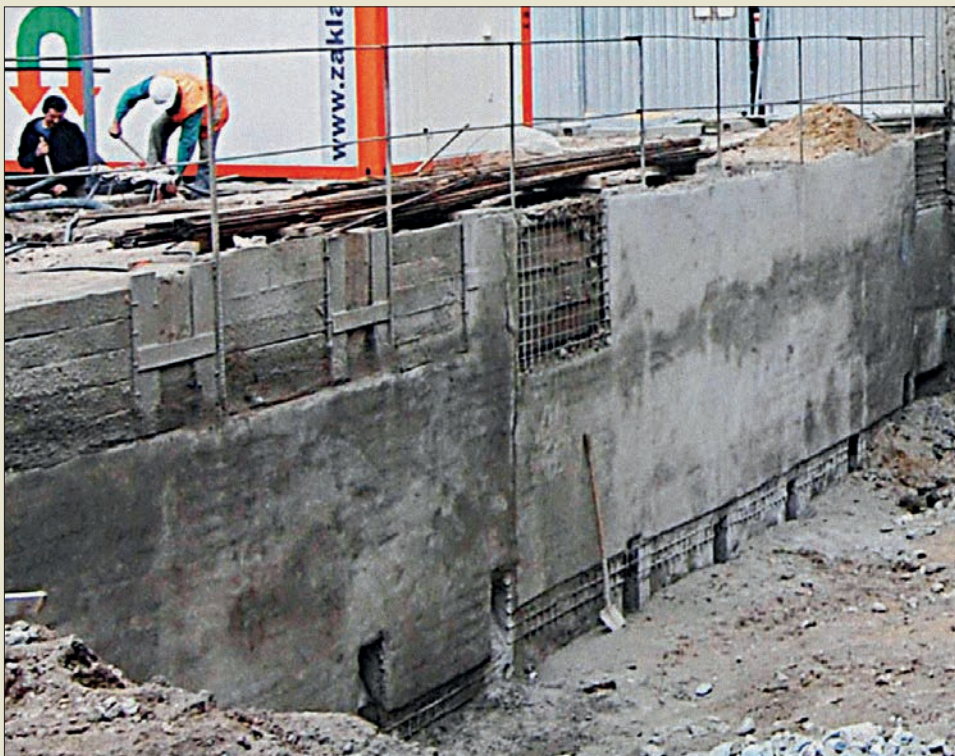
Obr. V. 67: Kompozitní pažicí a těsnicí podzemní stěna s vloženými I-profily a mezilehlými armokoši na stavbě domu v pražské Petrské ulici roku 2009 (Zakládání staveb, a. s.)
