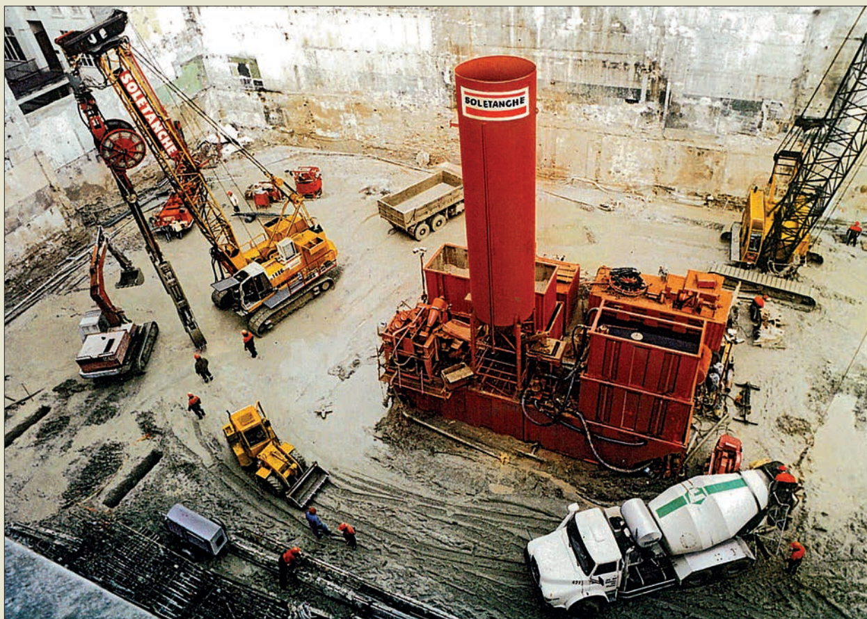
Obr. V. 60: Pohled na pracoviště podzemních stěn firmy Soletanche s kompaktní výrobou a čističkou pažící bentonitové suspenze na stavbě ve Francii v roce 1991. Jsou zachyceny všechny další části technologie od hybridního drapáku a odklízení výkopku přes přípravu stopendů a armatury až k betonáži s těžkým servisním bagrjeřábem.
