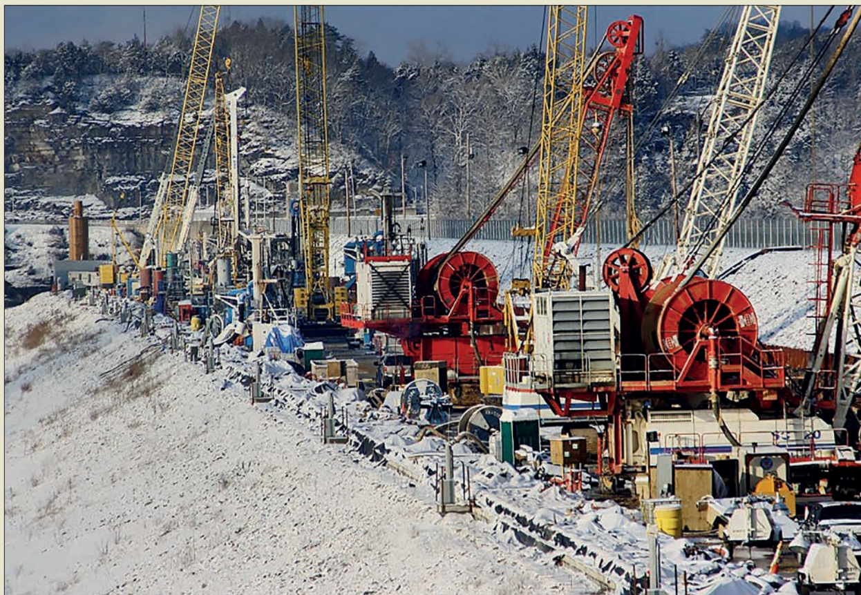
Obr. V. 74: Havarijní rekonstrukce těsnicí clony zemní přehrady Wolf Creek na řece Cumberland v Kentucky roku 2014. Nově byla k odstranění průsaků krasovým podložím zřízena betonová podzemní stěna do hloubky 90 m. Na koruně hráze byla při provádění skutečná skrumáž speciálních těžkých mechanismů firem Soletanche a Trevi.
