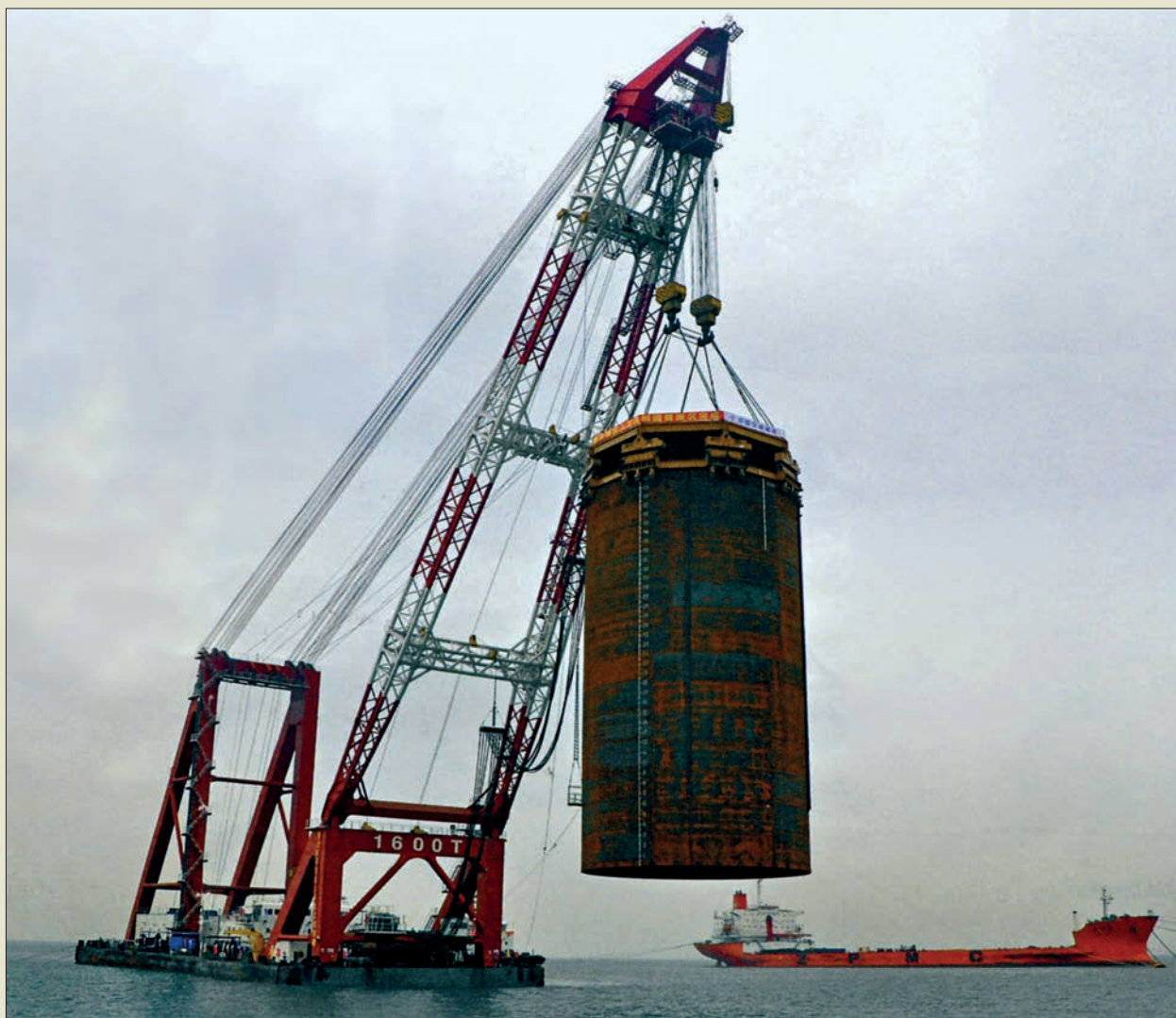
Obr. III. 8.: Vibroberanění výpažnice o průměru 22 m a délce 39,6 m pro základovou jímku mostu Hong Kong Zhuhai-Macu v Čínském moři roku 2012. Čínský dodavatel použil osmidílný vibrátor firmy American Piledriving Equipment.
