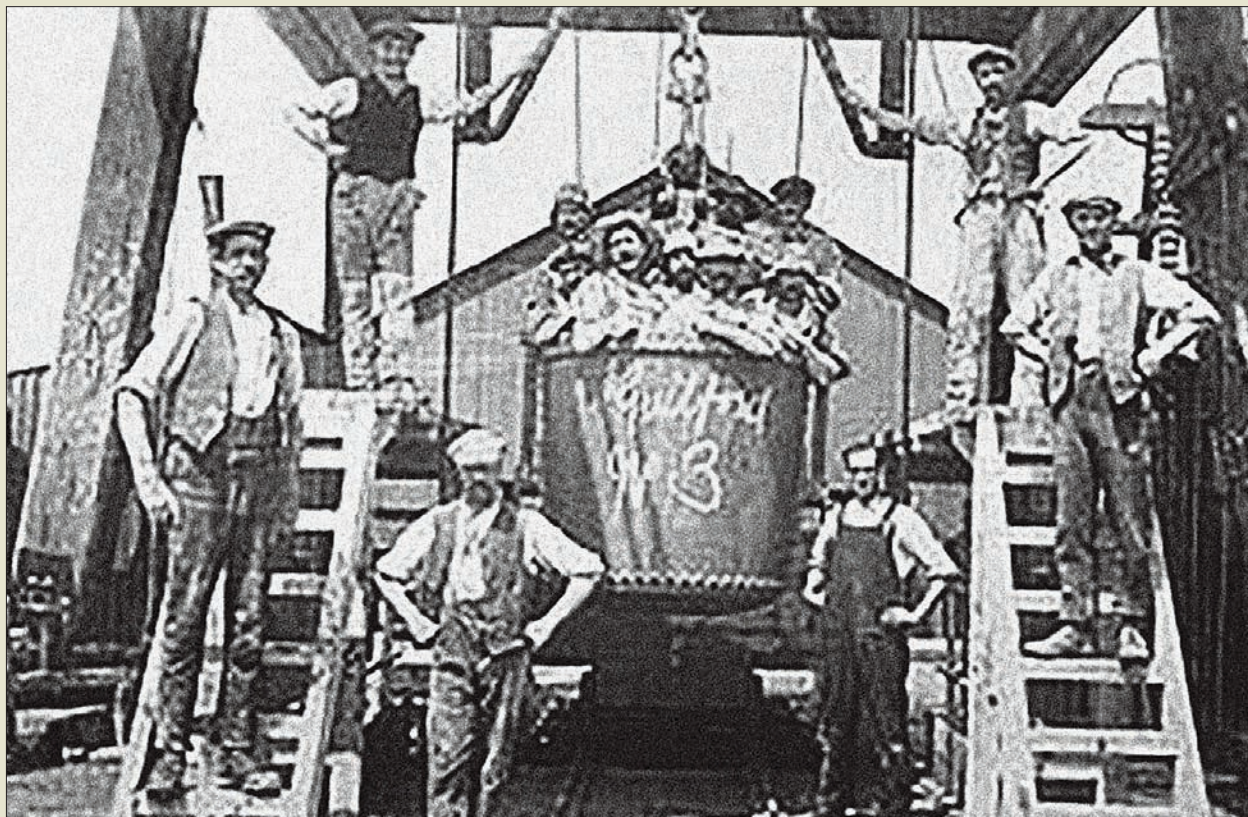
Obr. VI. 6: Těžba šachty dolu Guilford roku 1920 v jižní Anglii, kde byla prováděna pro zajištění prací injektáž.
