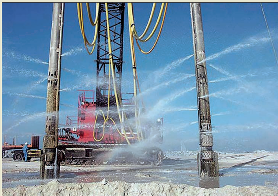
Obr. VI. 109: Souprava dvojitých vibroflotů z flotily 16 vysoce výkonných vibroflotačních zařízení nasazených roku 2007 na vibrohutnění umělého poloostrova dubajského Palm Project do hloubky 15 m (Soletanche- Bachy/Vibroflotation Group)
