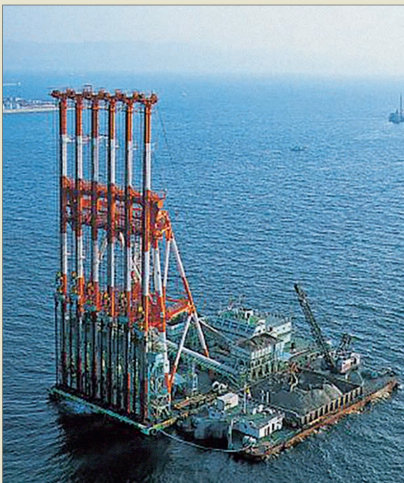
Obr. VI. 116: Jedna z flotily několika obřích plovoucích souprav s baterií vibračně zarážených ocelových výpažnic se ztracenou botkou, použitých koncem osmdesátých let pro zřizování pískových drénů o průměru 40 cm do hloubky 20 m pod mořské dno pro letiště Kansai
