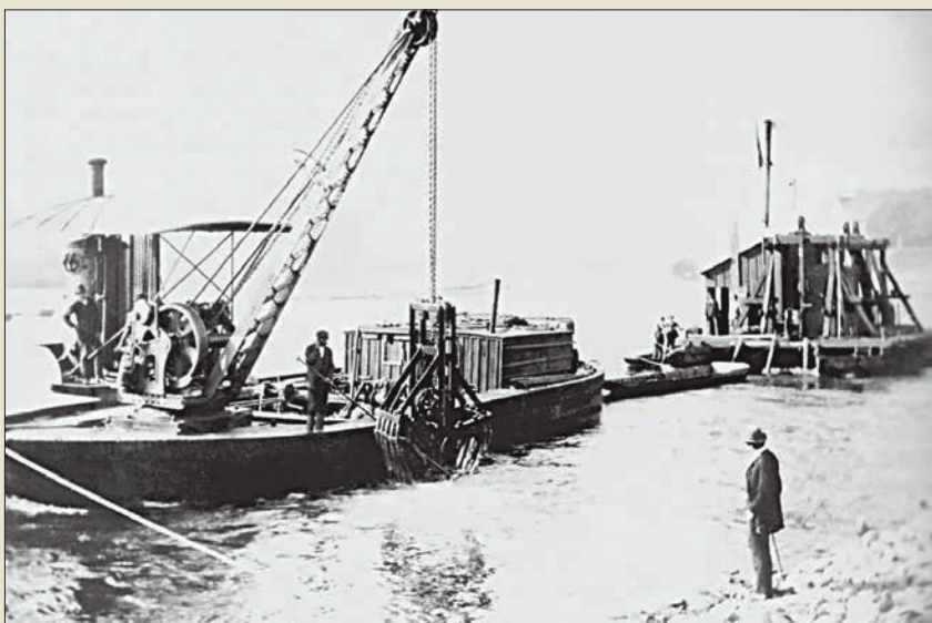
Obr. V. 8: Dvouřetězový Priestmanův drapák č. 1 firmy Lanna spolu s kesonovou lodí na stavbě jezu v Troji roku 1889 (Z. Bauer)
