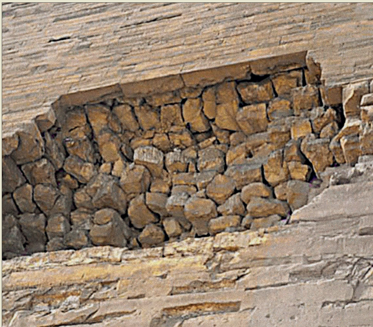
Obr. V. 26: Pyramida Meidum v Egyptě z období 2750 př. n. l. s poruchou líce obnažující pohled na vnitřní stavbu z kamenné rovnaniny
