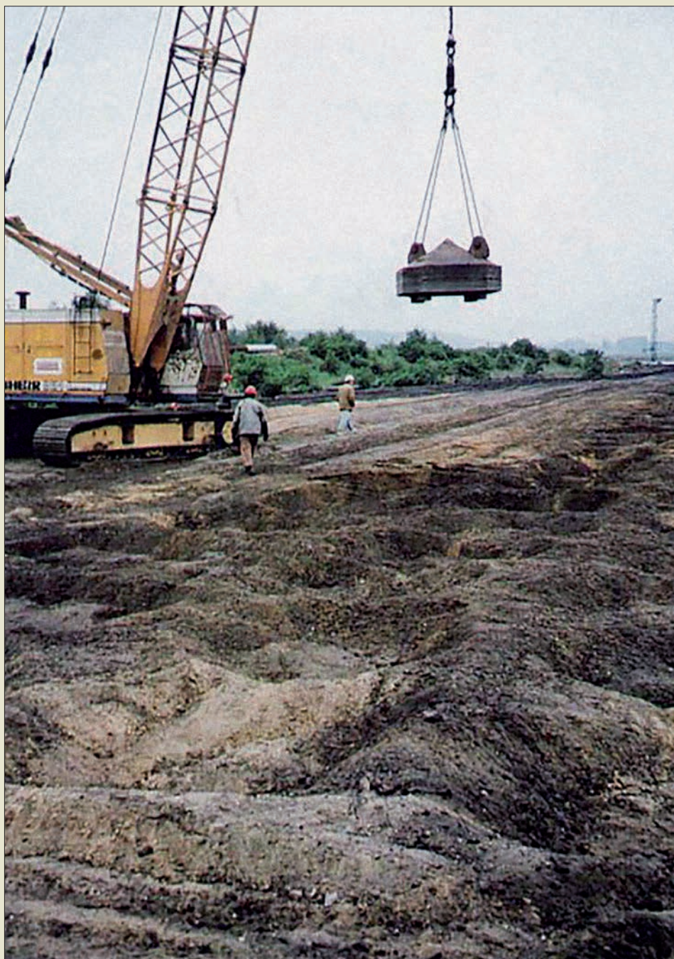
Obr. VI. 114: Dynamické hutnění/ konsolidace pro úpravu skládky Spolany Neratovice provedené roku 1994 firmou Soletanche ČR. Pěch o tíze 15 t a s výškou pádu 20 m působil na vrstvu různorodých odpadů o mocnosti 7,5 m.
