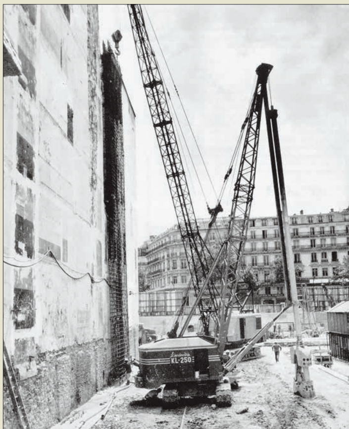
Obr. V. 52: Lanový drapák firmy Soletanche vybavený vodící kelly tyčí z pilotovací vrtačky na stavbě na bulváru Haussmann v Paříži roku 1966
