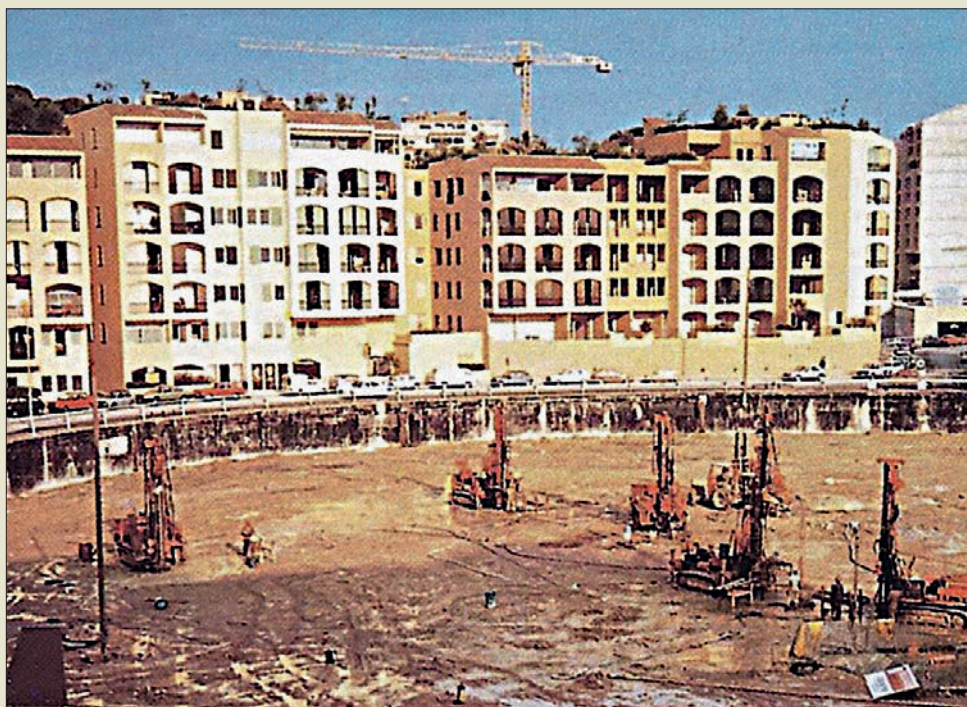
Obr. VI. 32: Hlubkové zvýšení ulehlosti podzákladí z kyprých zemin zhuňovací injektáží na stavbě obytného komplexu v monackém přístavu Fontvieille firmou Soletanche roku 1986
