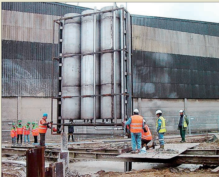
Obr. VI. 135: Instalace prefabrikovaného třístupňového reaktoru z nerezové oceli do připravené rýhy v místě brány mezi vertikálními bariérami ze štětovic při sanaci v belgickém Zvevegemu roku 2002 firmou Soletanche-Bachy
