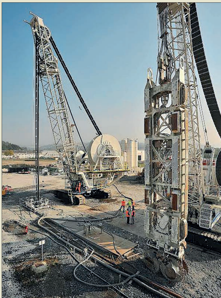
Obr. V. 57: Dvě soupravy hydrofréz nového typu Tiger SC-135 (vpravo) a SC-200 italské firmy Soilmec při zhotovování zkušební podzemní stěny hloubky 250 m v roce 2012
